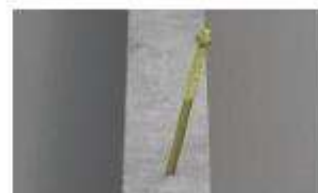
アンカーが鉛直ではない
